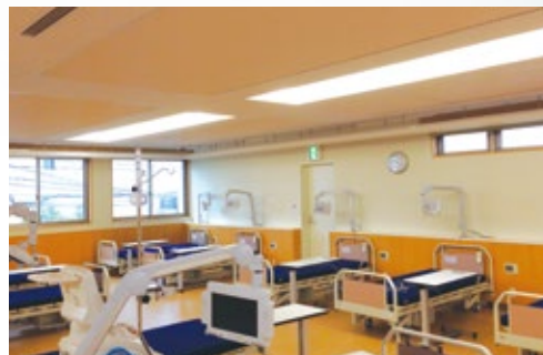
東大阪市某クリニック透析室 放射パネル施工例
