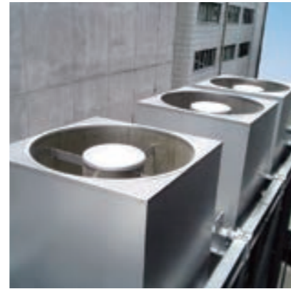
東京都内某施設 屋外機騒音対策
