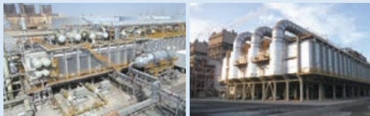
レヒート型海水淡水化プラント
