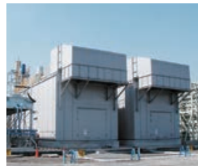
ガスエンジンエンクロージャー騒音対策
