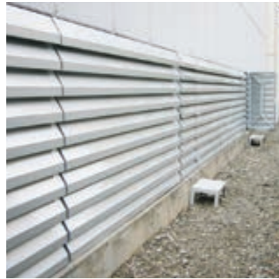
変電所 屋外機騒音対策
