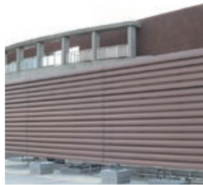
大阪府内某施設 屋外機騒音対策
