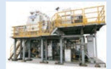
VVCC蒸発濃縮装置(MVR型蒸発濃縮装置)
