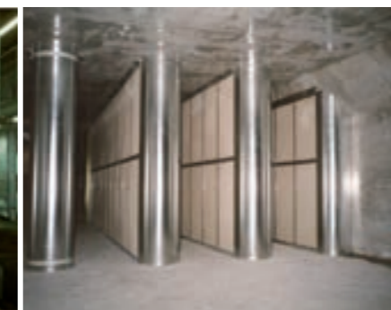
地下鉄 換気騒音対策
